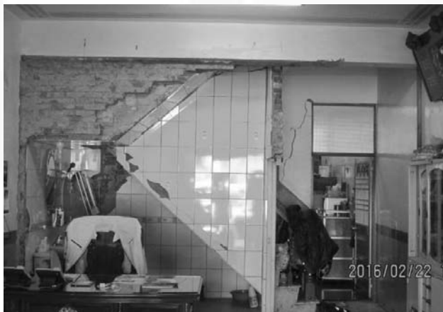
2016 台南玉井民房磚牆於美濃地震之損壞與倒塌
